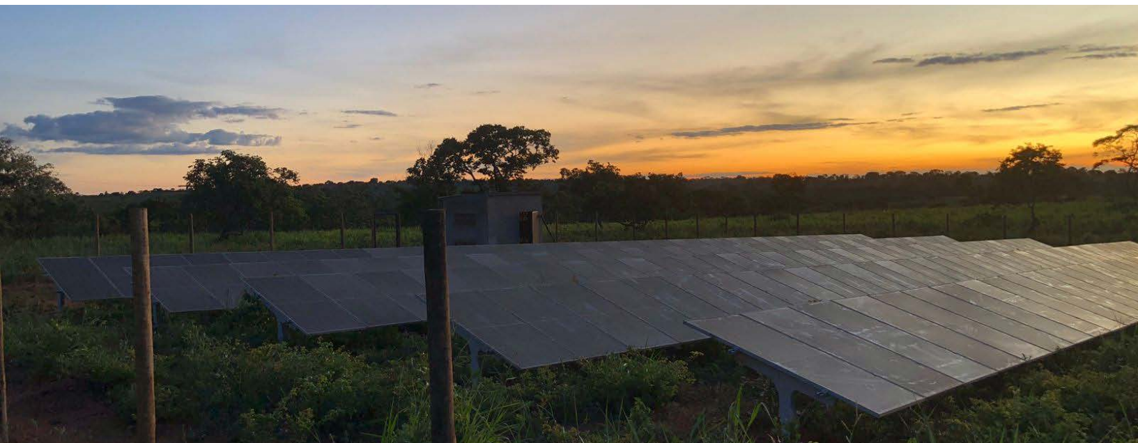
Placas em funcionamento em Mirabela (MG)
